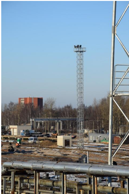
17.att. Uzstādīts apgaismojuma tornis
