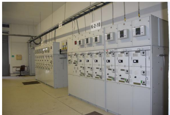
33.att. Atjaunotā elektro apakšstacija
