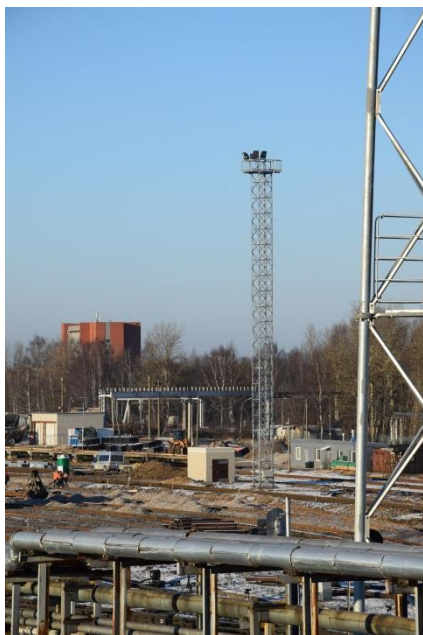
17.att. Uzstādīts apgaismojuma tornis
